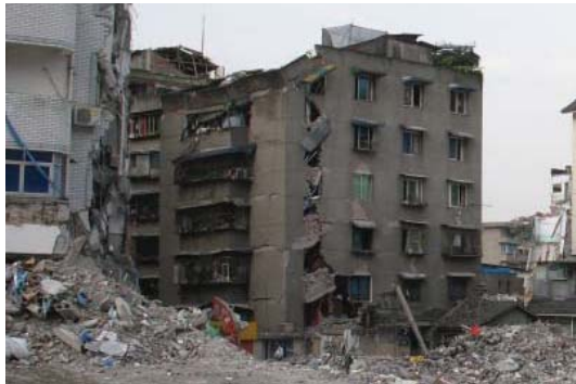
a. Collapsed wing
